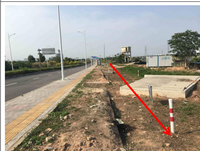
110kV地下电缆线沿沿江大道向南走向
