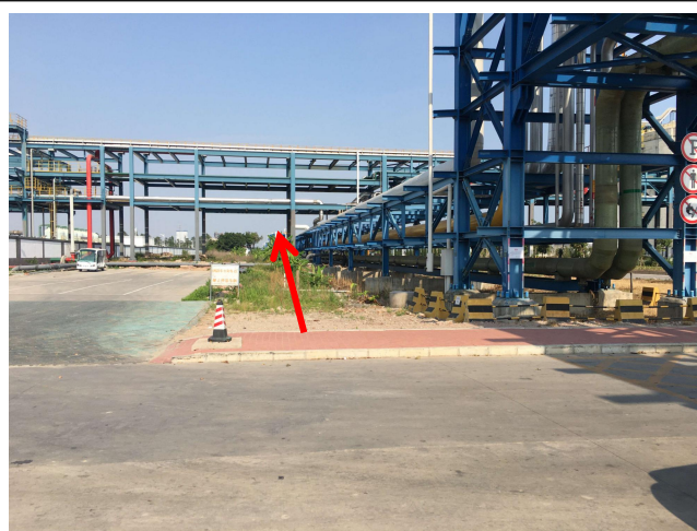
110kV地下电缆沿石化三路公共管廊向东走向
